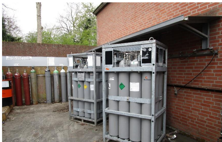
Foto: opstelplaats gasflessen
