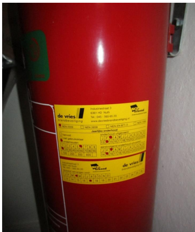
Foto: brandblusser met keuringslabel
